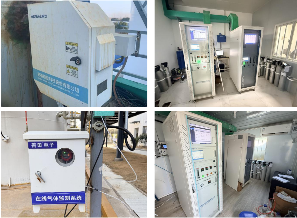
图 4.2-3 废气在线监测设备现场图
