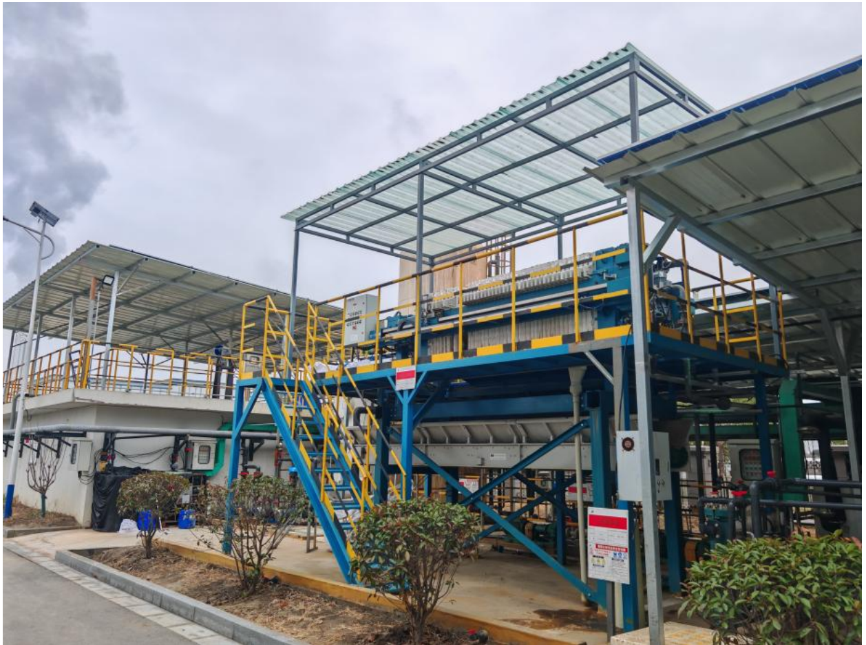
图 4.1-3 废水治理设施图
