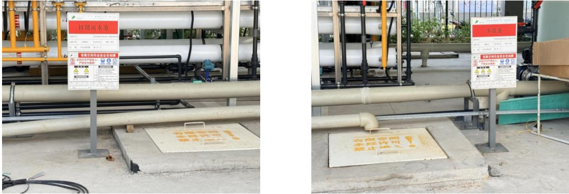
图 4.2-1 初期雨水池和事故池现场图
