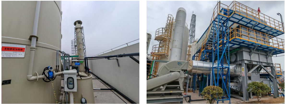
图 4.1-4 废气治理设施图
